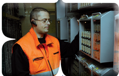
Sikrings- og signalanlæg
