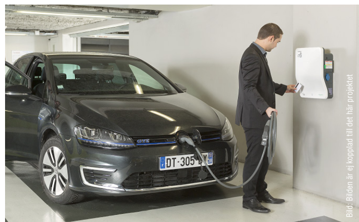
På Telenors huvudkontor på Forneby, Oslo, ska 90 laddstationer för elbilar installeras. Lösningen är projekterad och designad av Bravida och installationerna beräknas vara klara i slutet av september. Fortum står för driften av anläggningen och är även beställare av Bravidas tjänster.
